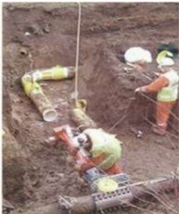
Fig 9 – Tipiche condizioni ambientali di installazione di tubazioni in plastica
